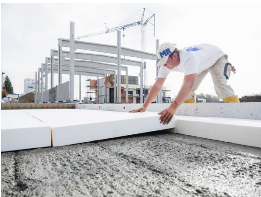
Auf die Vorsatzschale mit dem Beton folgt die Dämmschicht aus Expandiertem Polysterol (ESP). Foto: Schöck Bauteile GmbH
