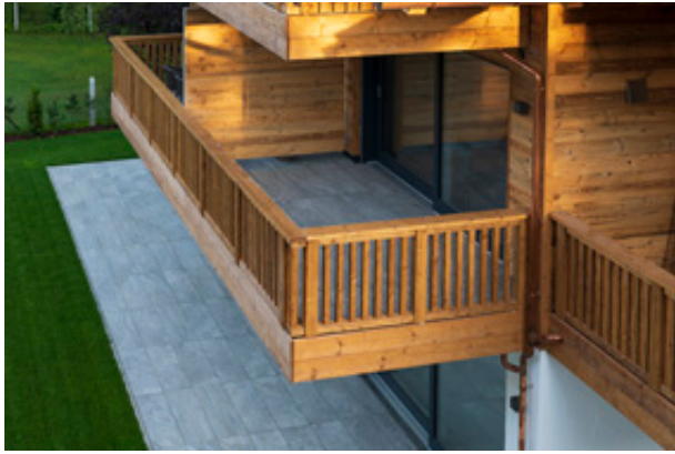
Die großen Balkone haben eine Auskrragung von bis zu 2,40 m. Fotos: Schöck Bauteile GmbH
