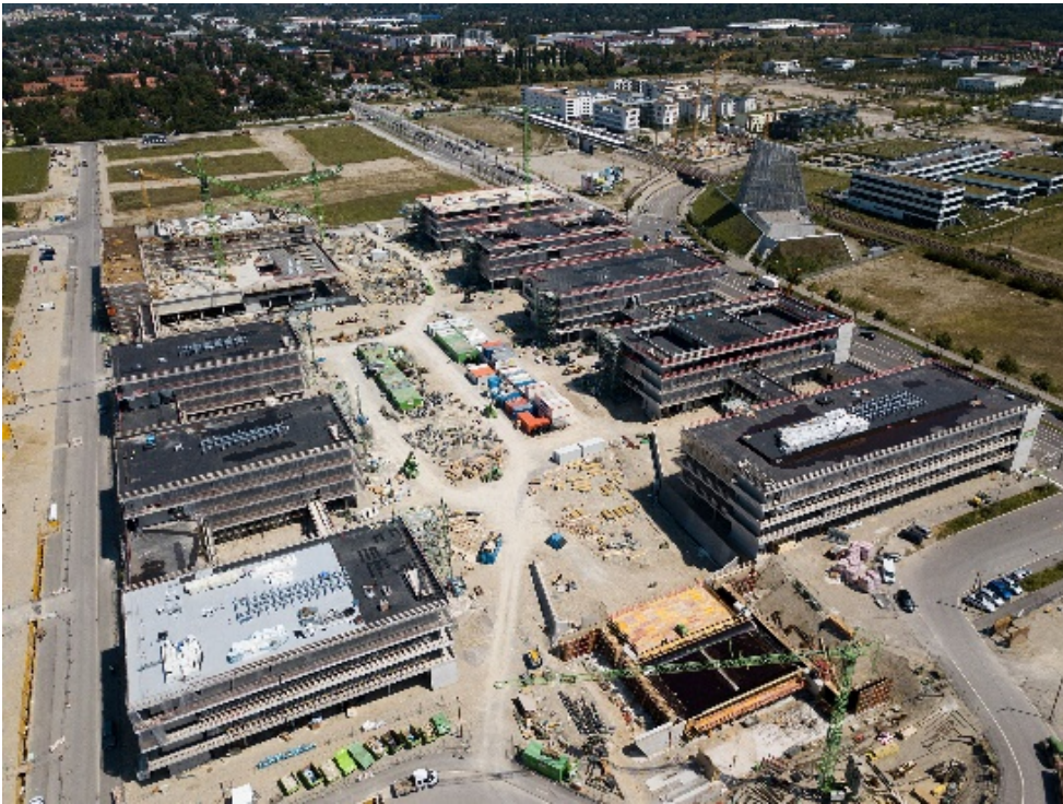
Der Bildungscampus ist das mit Abstand größte Schulbauprojekt der Landeshauptstadt München und eines der größten in Deutschland. Foto: Glass GmbH Bauunternehmung, Abdruck honorarfrei.
