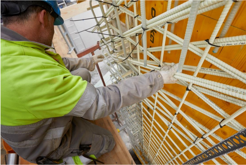
Der Bauherr legt viel Wert auf ein gesundes Arbeitsumfeld und wünschte keine Stahlbewehrung. Der Ingenieur schlug den Glasfaserverbundwerkstoff Combar vor. Foto: Antal Thoma, Abdruck honorarfrei.
