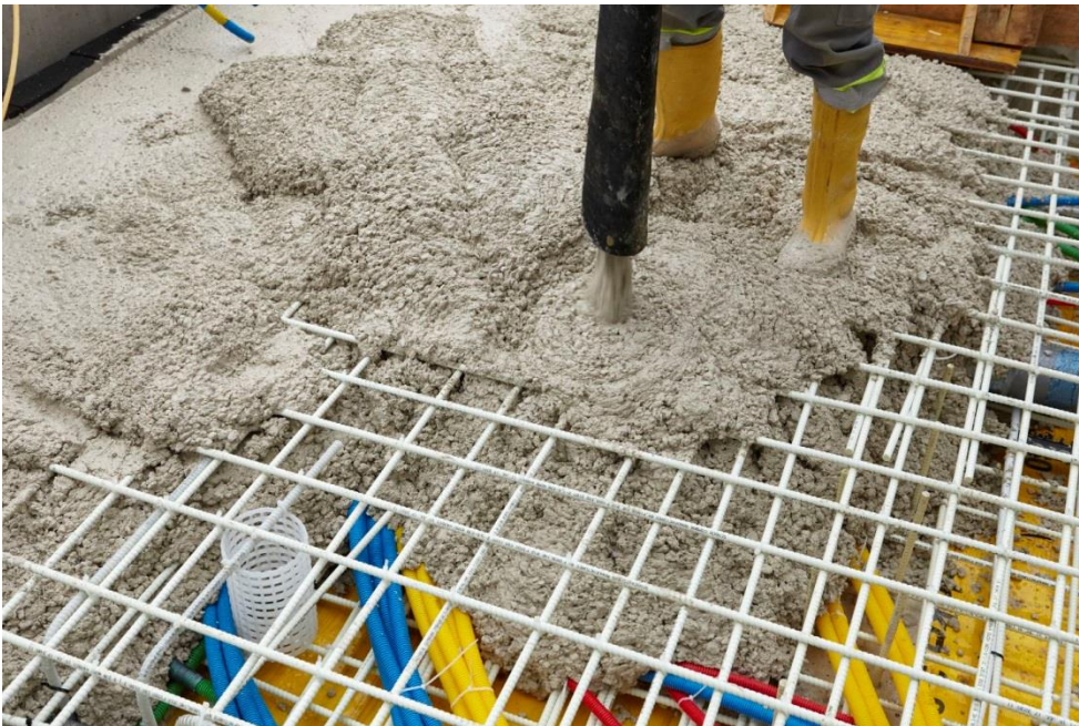
Die Spezialbewehrung mit Combar von Schöck wird auf die gleiche Weise verarbeitet wie Stahl. Foto: Antal Thoma, Abdruck honorarfrei.
