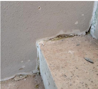
Abb. 4: Schallbrücke durch Folgewerk
