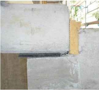
Abb. 2: Schallbrücke durch lückenhafte Baustellenslösungen
