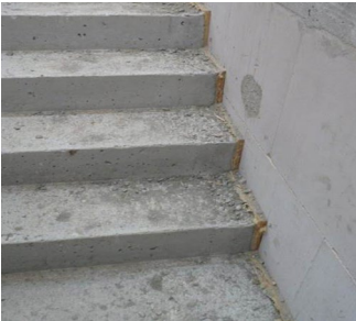
Abb. 8: Zu weiche Materialien bilden die Gefahr von Schallbrücken (sich eindrückende Steine während des Baufortschritts).
